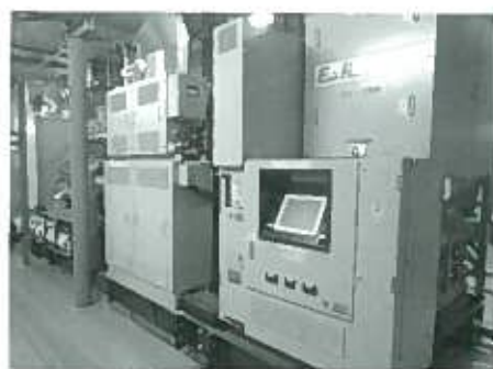
コージェネレーションシステム (ガスインジン)
